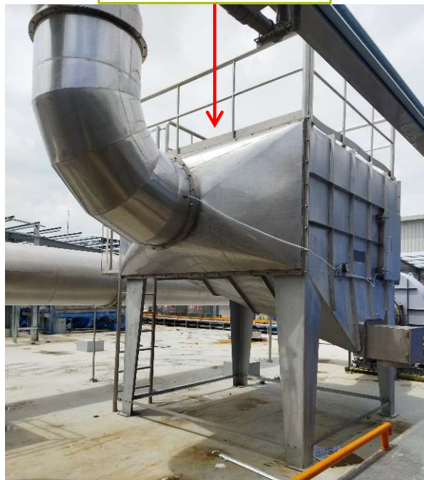
活性炭淨化 處理設備
